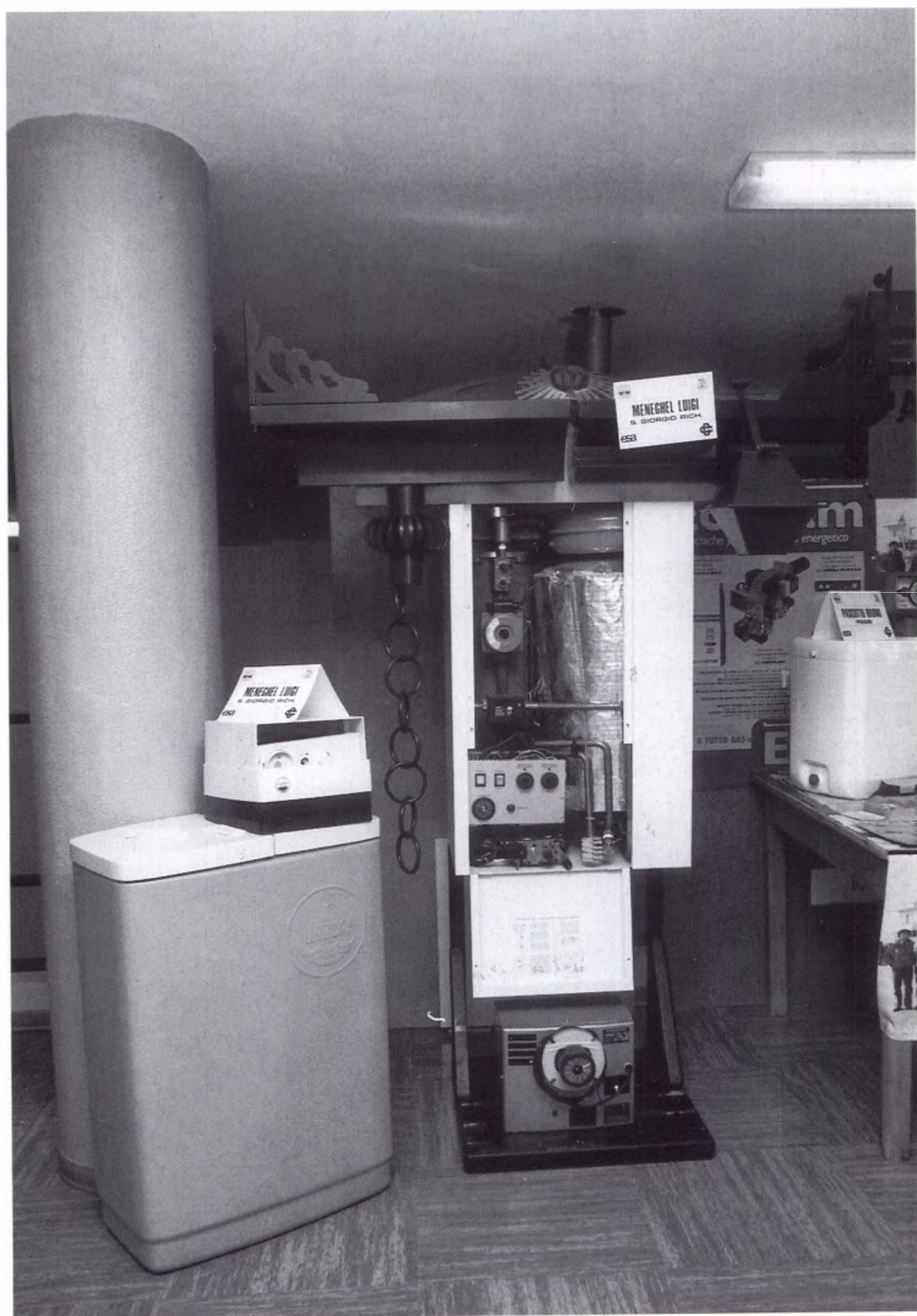
Lena & Meneghel s.d.f. - Termoidraulici - Lattonieri - Via Stazione, 1 - S. Giorgio R.da Tel. 96178 ( Inizio attività 1.2.80 )
