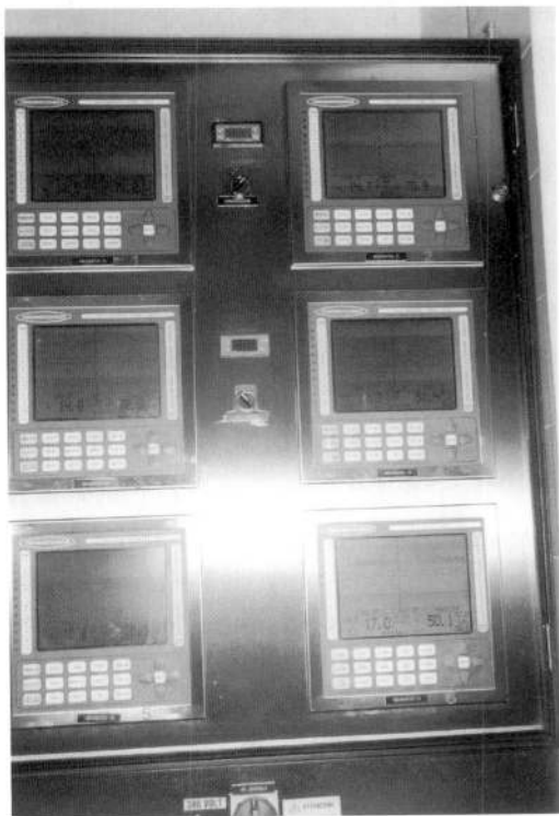
Apparecchiature computerizzate controllano la temperatura di una cella di asciugamento.
