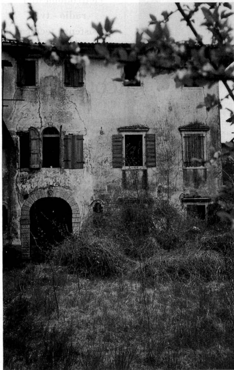
Particolare della villa costruita dai conti di Spilimbergo nel XVII sec. Già prestigiosa residenza ora è in stato di grave degrado. (Foto Mara Chiaradia)
